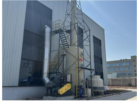
水喷淋+布袋除尘废气处理设施
