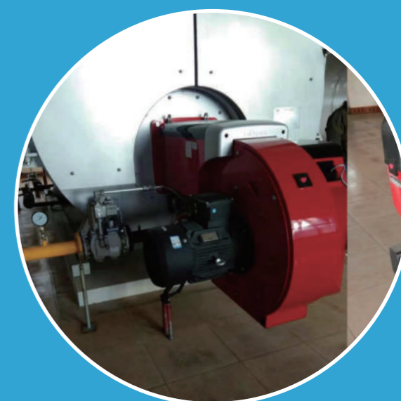
安装地：北京体育大学 锅炉型号：3.2MW 热水锅炉 1台 燃烧器型号：GP-350M WD 200 FGR NOx 排放：< 30mg/m 3 n
