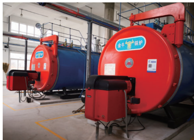
安装地：西安航天 165 所 锅炉型号：4.2MW 热水锅炉 2 台 燃烧器型号：GP450M WD200 FGR NOx 排放：< 30mg/m 3 n
