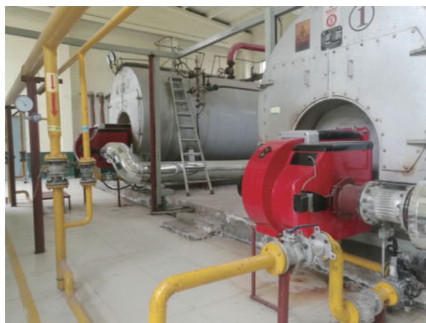
安装地：西安航天 165 所 锅炉型号：4.2MW 热水锅炉 2 台 燃烧器型号：GP450M WD200 FGR NOx 排放：< 30mg/m 3 n
