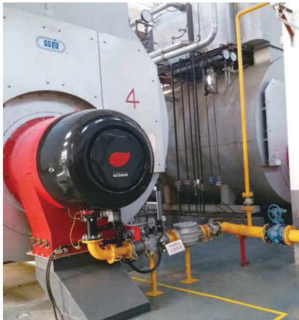
安装地：河南郑州宇通客车 锅炉型号：14MW 蒸汽锅炉 4 台 燃烧器型号：4 台 GT-16A WD200 DN100 FGR NOx 排放：< 30mg/Nm 3
