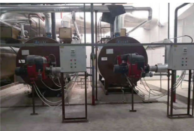
安装地：西安万科城市之光 锅炉型号：2 吨热水锅炉 2 台 燃烧器型号：GP140M WD200 FGR NOx 排放：< 30mg/m 3 n
