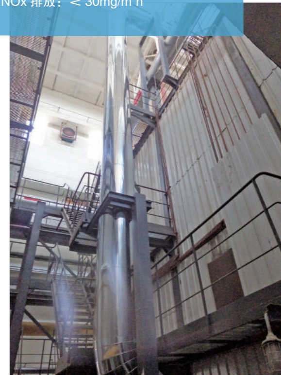
安装地: 北京热力集团 锅炉型号: 75吨蒸汽锅炉 2台 燃烧器型号: GT-35U FGR NOx 排放: < 30mg/m 3 n
