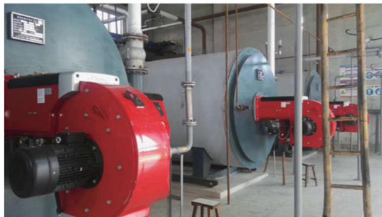
安装地：北京兆丰家园 锅炉型号：5.2MW 热水锅炉 1台 燃烧器型号：GP-450M WD 200 FGR NOx 排放：< 30mg/m 3 n
