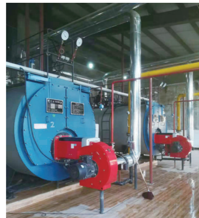
安装地：陕西蒲白煤矿 锅炉型号：4.8MW 热水锅炉 3 台 燃烧器型号：GP450M WD200 FGR NOx 排放：< 30mg/m 3 n
