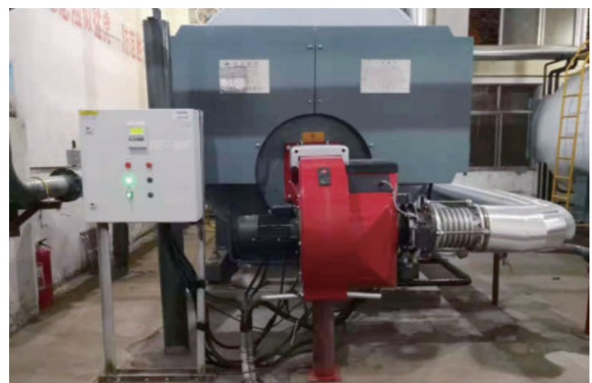
安装地：西安体育中心 锅炉型号：4 吨热水锅炉 1 台 燃烧器型号：GP350M WD200 FGR NOx 排放：< 30mg/m 3 n
