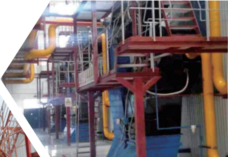
安装地：乌鲁木齐华源热力 锅炉型号：70MW 热水锅炉 10 台 燃烧器型号：GT-50U FGR NOx 排放：< 60mg/m 3 n
