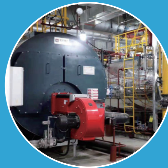
安装地：北京庄胜物业 锅炉型号：2.8MW 热水锅炉 2台 燃烧器型号：2台 GP-350A WD200 DN65 FGR NOx 排放：< 30mg/Nm 3
