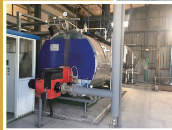
安装地：浩盟车料（上海）有限公司 锅炉型号：3 吨蒸汽锅炉 1 台 燃烧器型号：GP-320M WD200 FGR NOx 排放：< 50 mg/Nm 3
