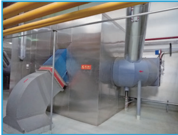
安装地：北京热力集团 锅炉型号：29MW 热水锅炉 3 台 燃烧器型号：GT-35U FGR NOx 排放：< 30mg/m 3 n
