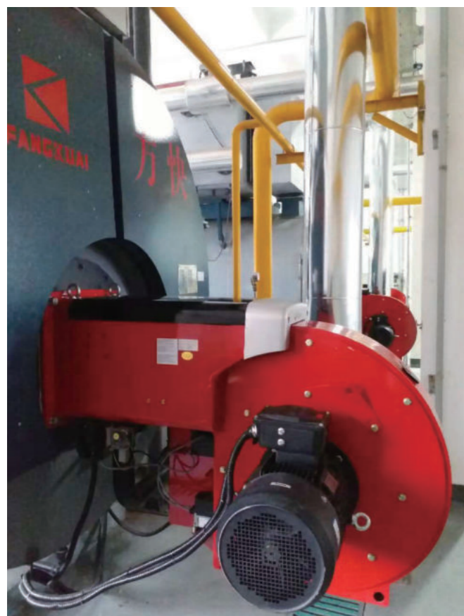
安装地：河南郑州精益达汽车配件 锅炉型号：4.2MW 热水锅炉 3 台 燃烧器型号：3 台 GP-450A WD200 DN65 FGR NOx 排放：< 30mg/Nm 3
