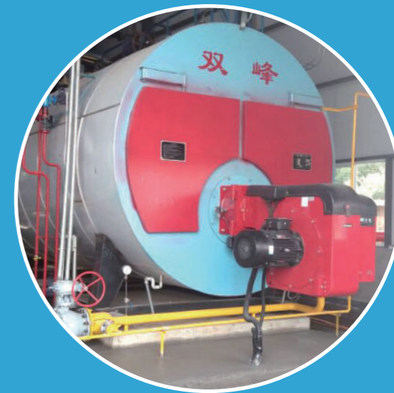
安装地：北京汇源农业生态有限公司 锅炉型号：10吨蒸汽锅炉 1台 燃烧器型号：GP-700M-II NOx 排放：< 80mg/m 3 n
